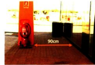
Amplitud de paso suficiente.
